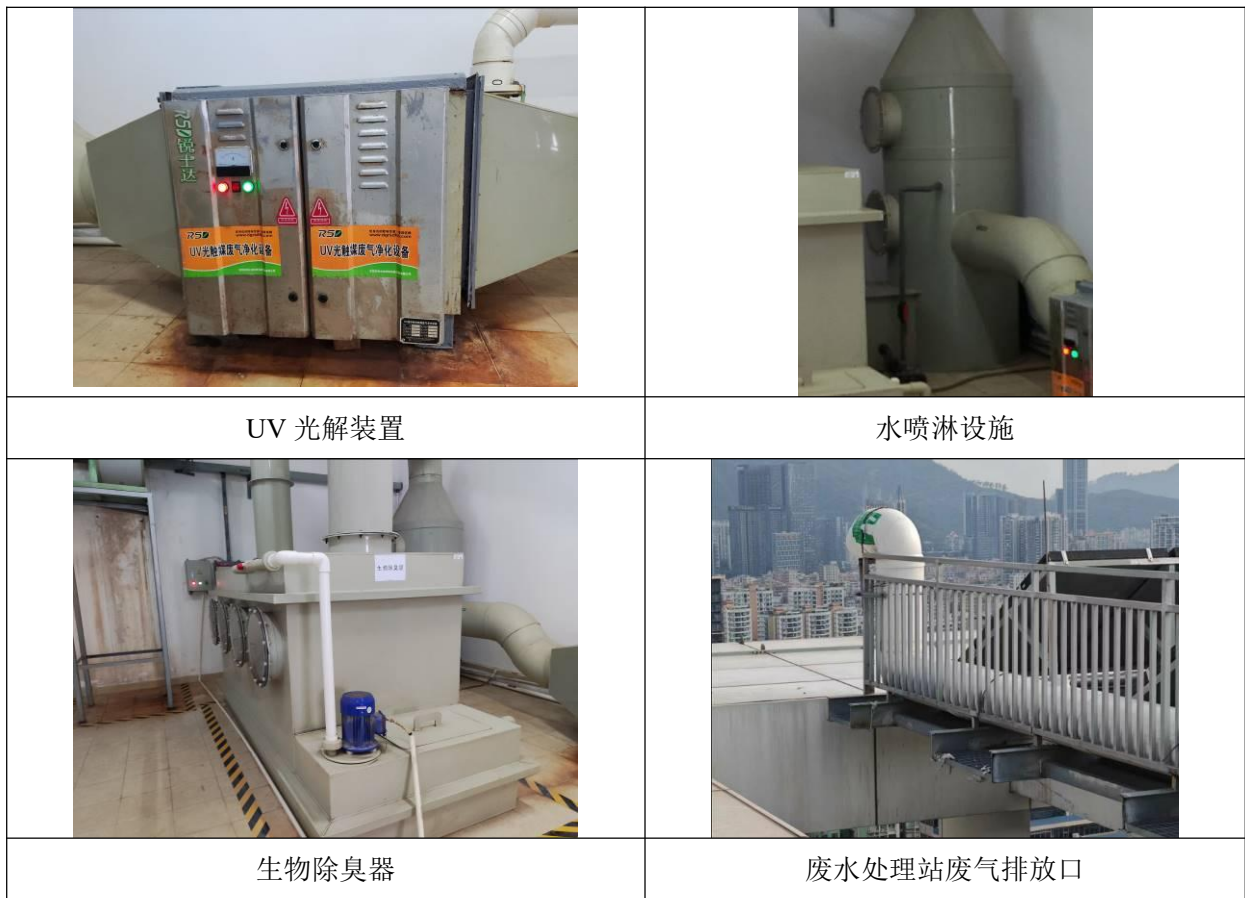
图 5-3 废水处理站臭气防治措施
