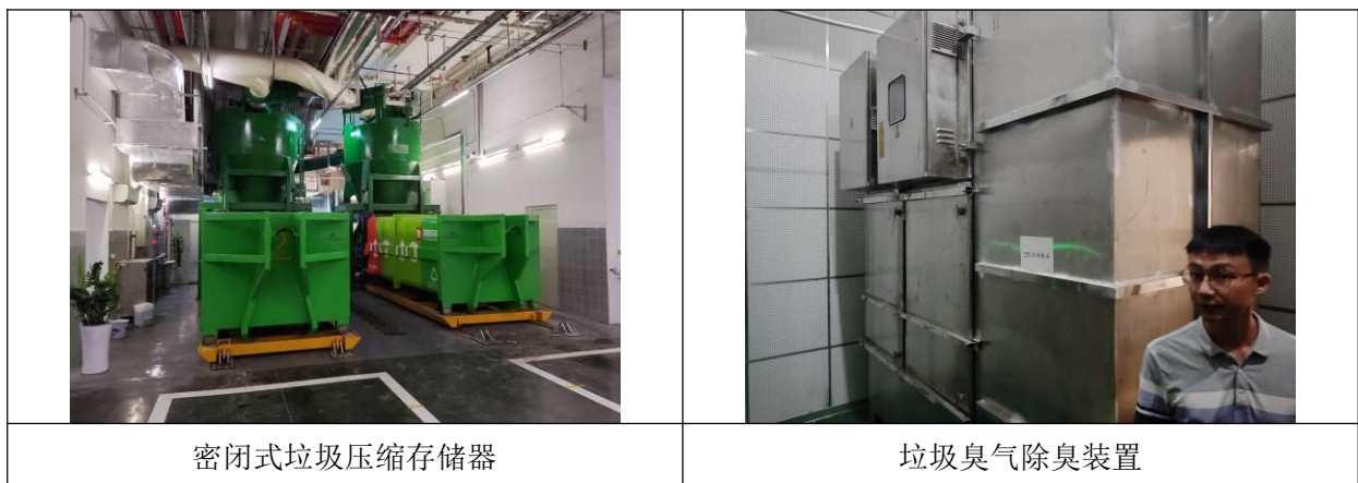
图5-10 垃圾站臭气处理设施
