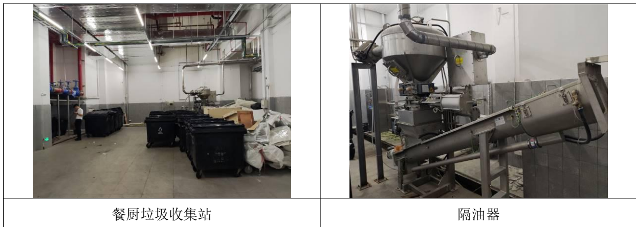
图 5-12 生活餐厨垃圾处理设施
